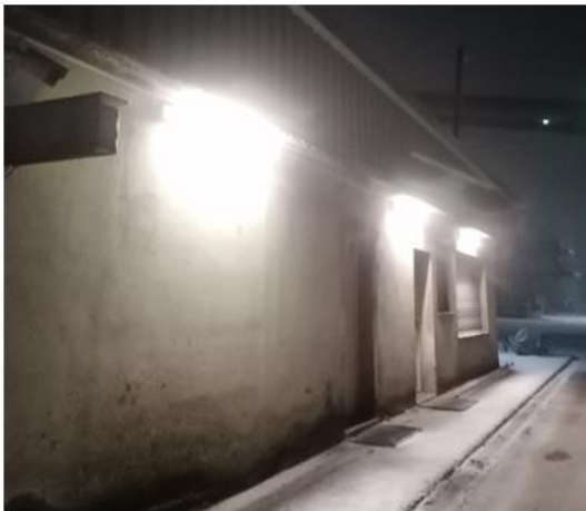
Abbildung 4: Zustand der Beleuchtung bisher am
